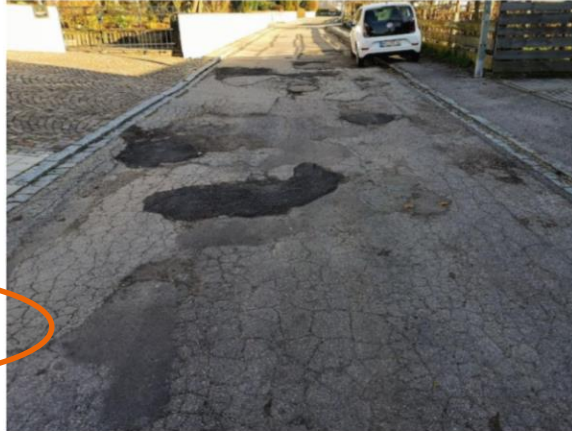
Abb. 1: Deutliche Schäden an der Straßeninfrastruktur
